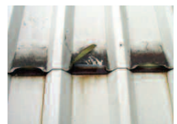
Dak van standaard plastisol op dampelverzinkt staal na 7 jaar.
